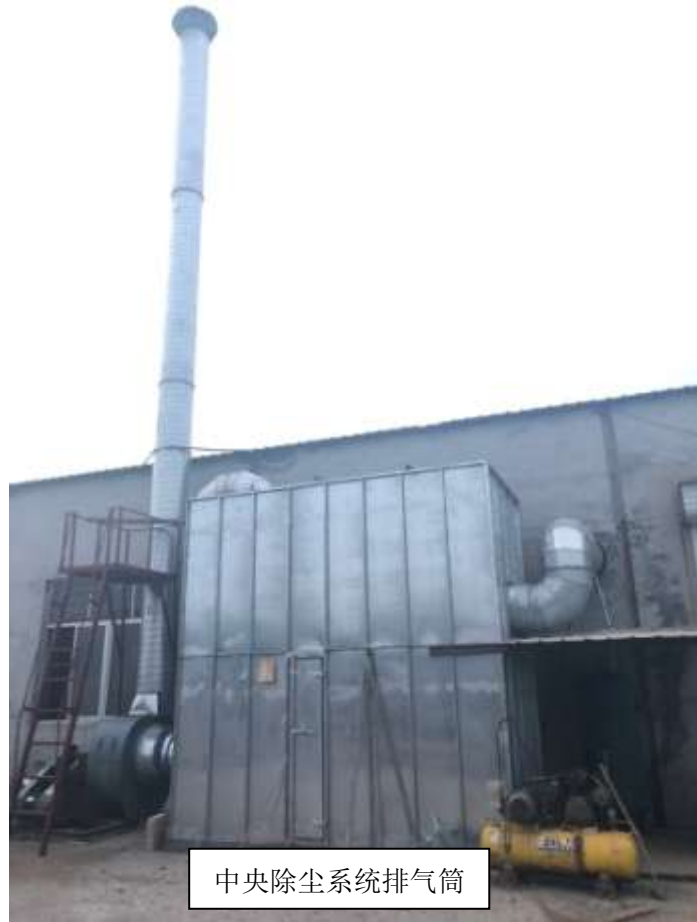
中央除尘系统
